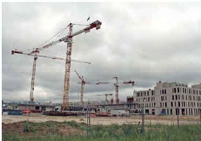
Après quelques mois de travaux, le premier bâtiment du futur établissement de Bezannes est d'ores et déjà sorti de terre. © L'Hebdo du Vendredi
