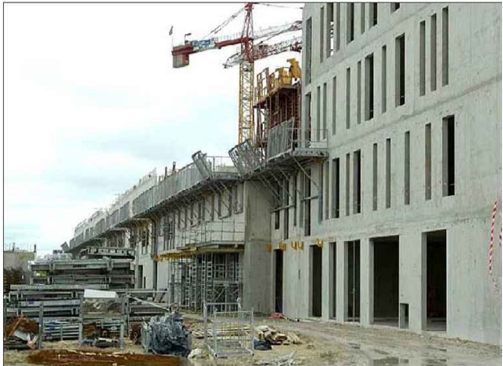
Sept mille mètres cubes de béton (soit 60 000 tonnes...) ont été coulés en un peu plus de 150 jours de travaux.
